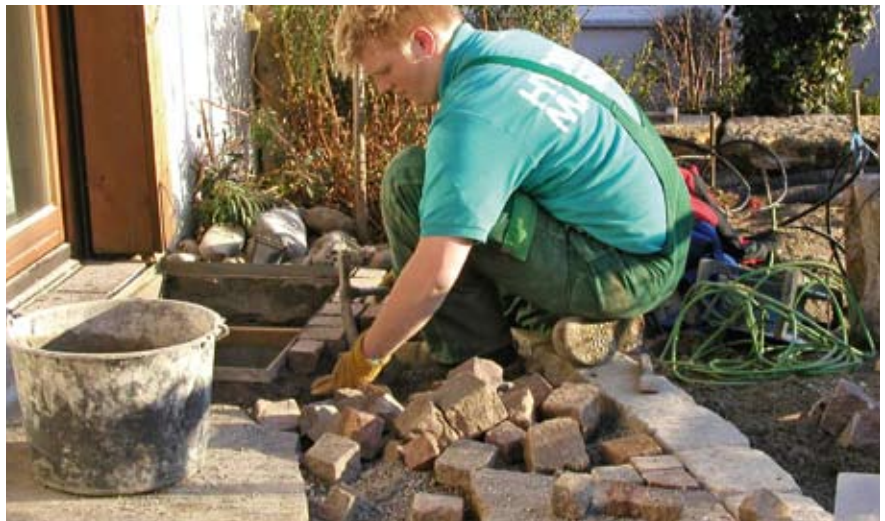
Gerade im privaten Umfeld wird die Leistung auf engstem Raum erbracht. Das gilt es bei Kalkulation und Organisation zu berücksichtigen.
