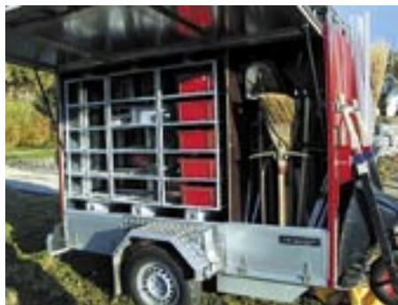
Ein perfekt ausgestatteter Beregnungsanhänger erleichtert das wirtschaftliche Arbeiten. Jedes Werkzeug und Material hat seinen festen Platz und ist auf der Baustelle verfügbar.
